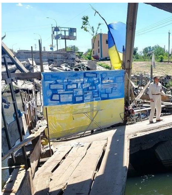
写真 2: 爆発により損壊したイルピンへ至る橋 (2022年6月3日)
