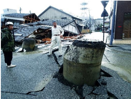
によきによきと死海の塩の柱のように隆起しているマンホール。
